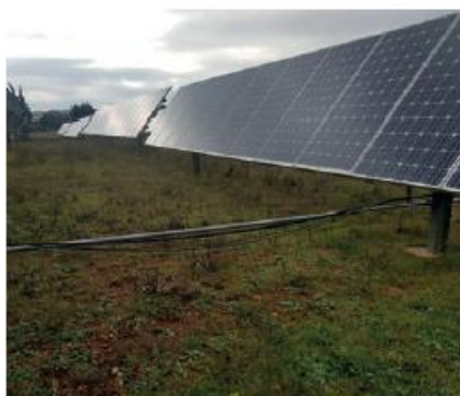
Photo 25: Des barres de commande trop basses dans un parc photovoltaïque trackers 1 axe d'ancienne génération (©Idéale)
